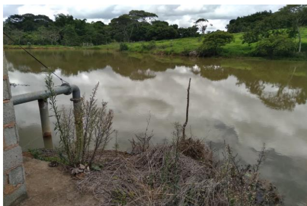
Figura 18: Captação em barramento.
