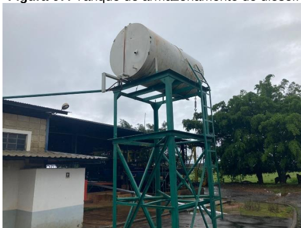
Figura 07: Tanque de armazenamento do diesel.
